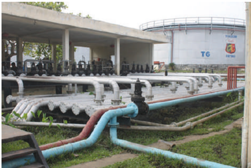
трубопроводы с запорной арматурой у нефтехранилища pipelines equipped with fittings for oil tanks цевоводе са запорним вентилима на нафтном складишту
